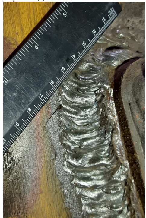
Рисунок 10 – Трещина 17 мм в сварном шве опоры двигателя (датчик № 12)
