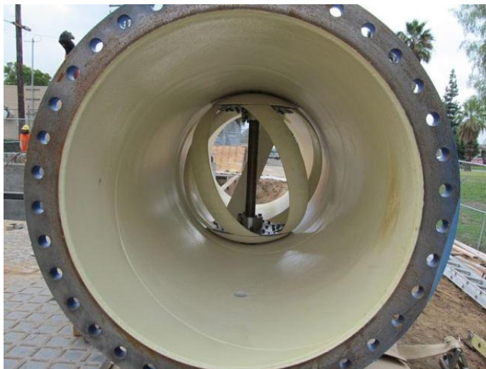
Рис. 2. Лопасты гидротурбины в трубопроводе
