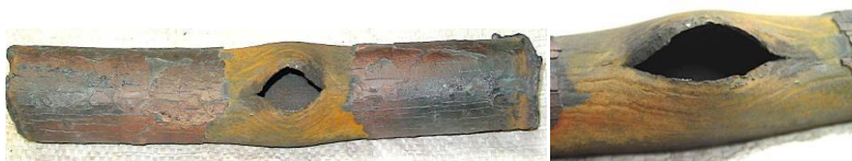
Рис. 2. Повреждённая труба конвективного пароперегревателя 5 ступени Котла №8 Ново-Кемеровская ТЭЦ
