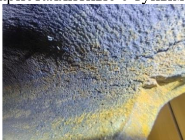
Рис. 4. Коррозионно-усталостные трещины на внутренней поверхности гребка.
