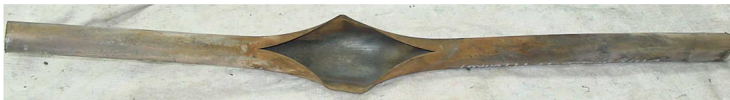
Рис. 1. Повреждённая труба потолочного пароперегревателя Котла №13 Кемеровская ГРЭС
