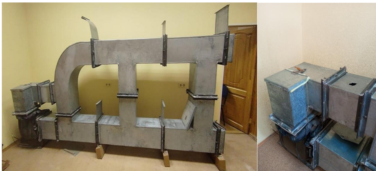
Рисунок 1 – Общий вид стенда (слева) и место нахождения технологического отверстия для измерения расхода воздуха на входе в вентиляционную систему (справа)
