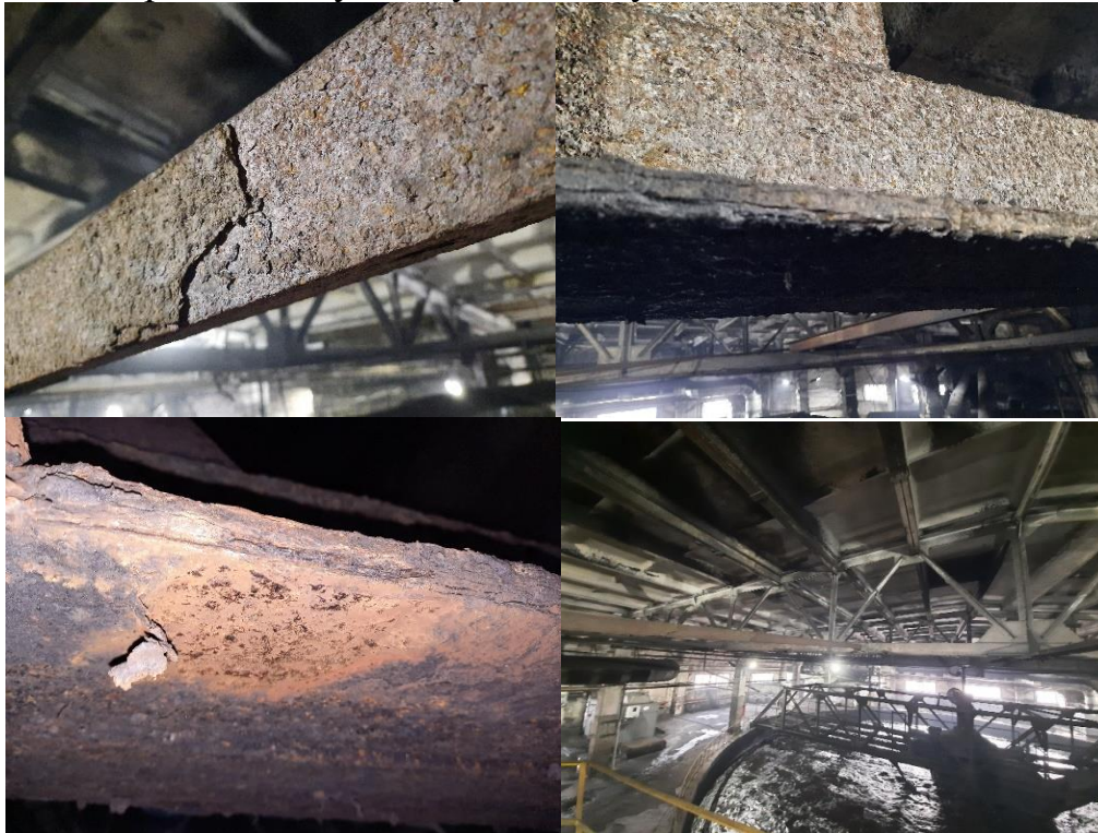
Рис. 1. Металл конструкций фермы, подверженный слоистой коррозии
