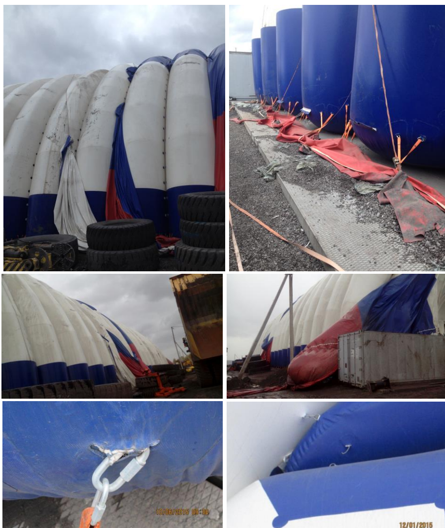
Рис. 4 – Повреждения элементов пневмоангара
