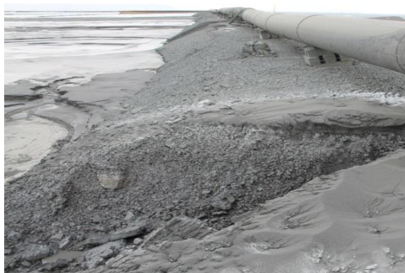
Рисунок 5. Крен опор золопроводов в результате вымывания верхового откоса
