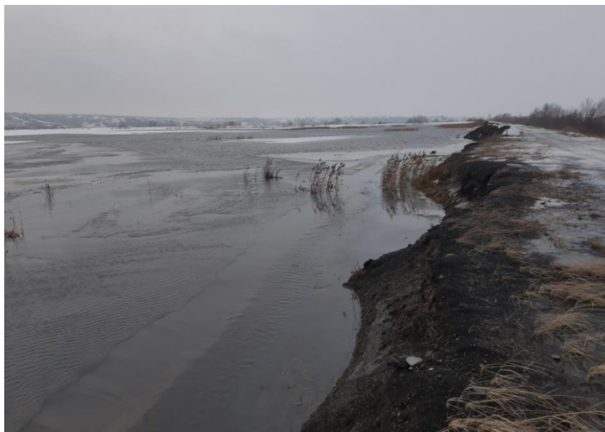
Рисунок 4. Разрушение внутреннего верхового откоса в результате воздействия на него потока сбросной пульпы
