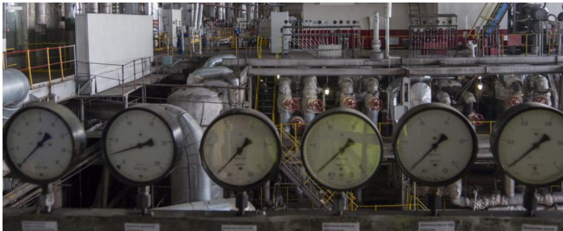
Рис.1. Манометры на Кемеровской ГРЭС
