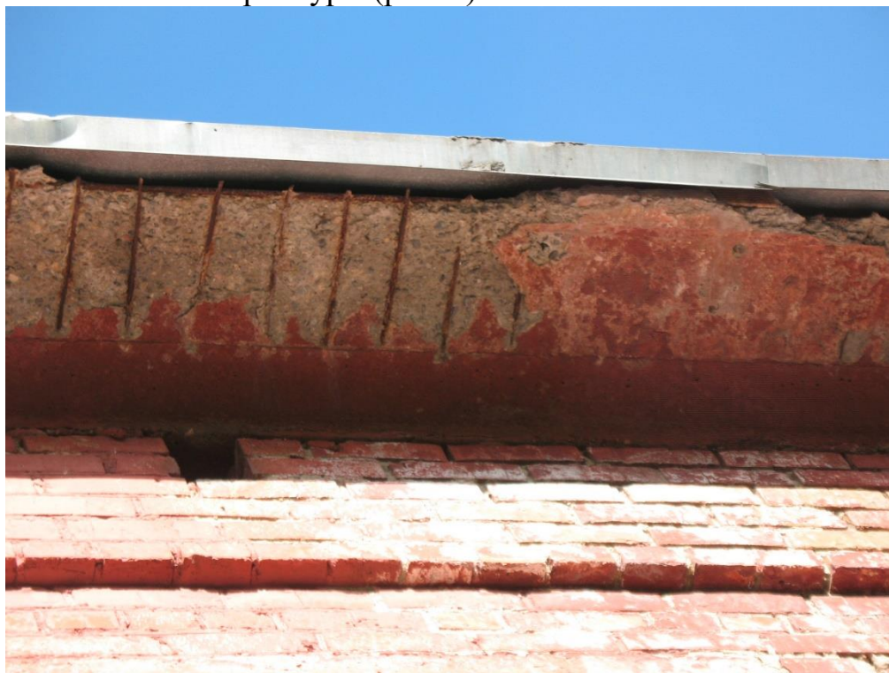
Рис. 6. Разрушение защитного слоя бетона карнизных плит
