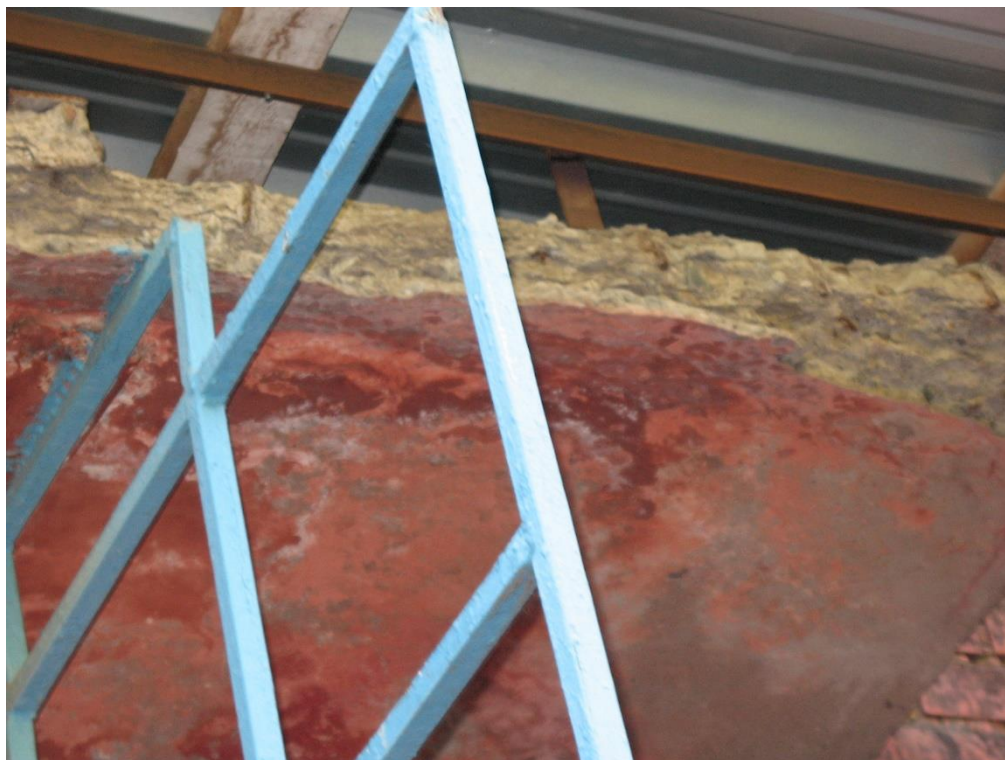
Рис. 9. Разрушения старых железобетонных козырьков
