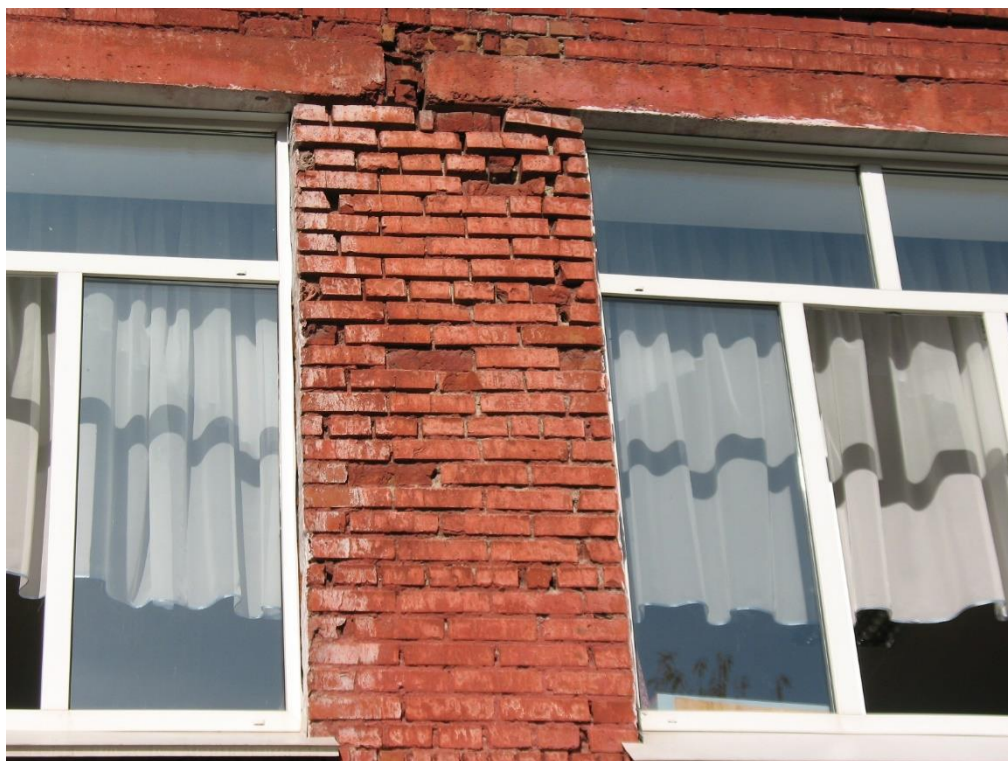
Рис. 8. Простенок, с нарушенной наружной верстой кладки
