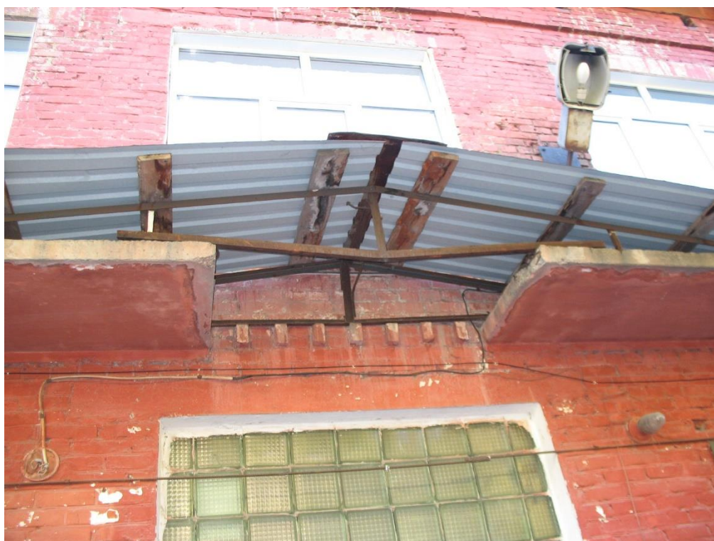
Рис. 10. Металлические элементы деформированы
