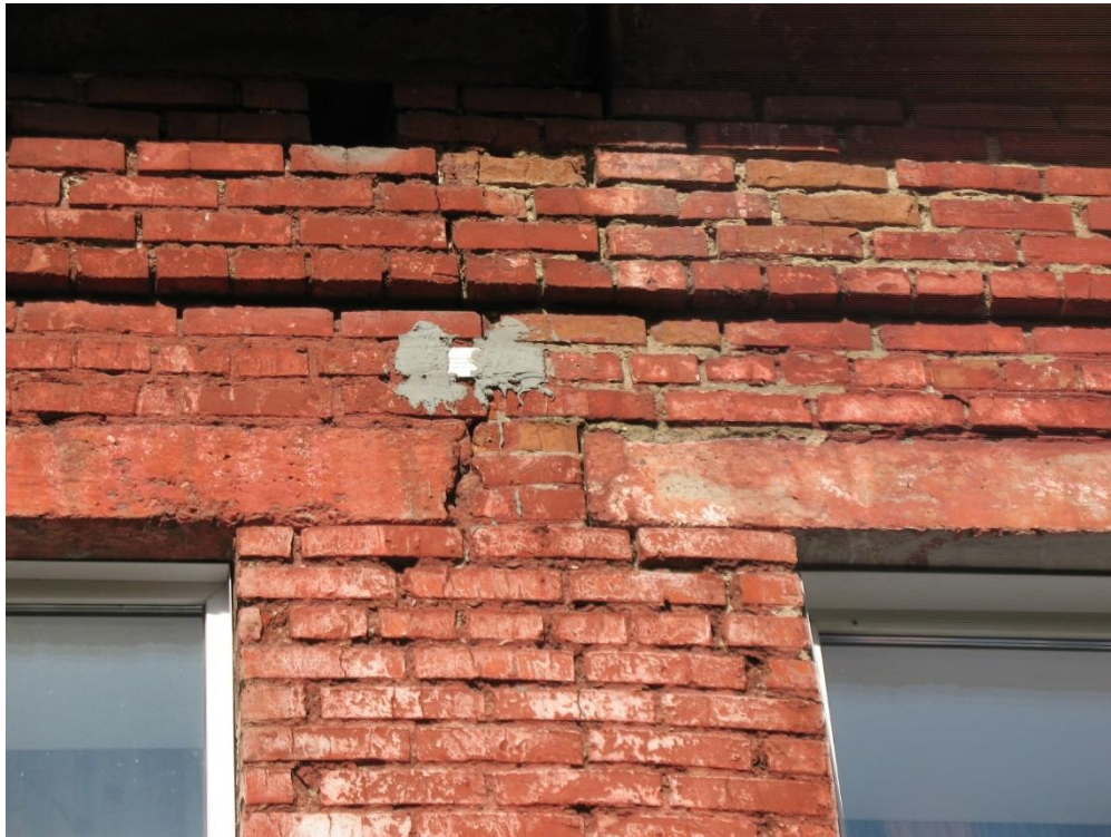
Рис. 7. Вертикальные трещины в подкарнизной части наружной стены
