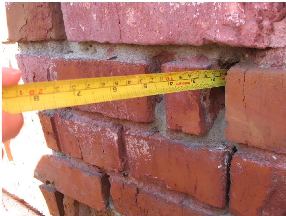
Рис. 4. Выветривание раствора кирпичной кладки наружной версты
