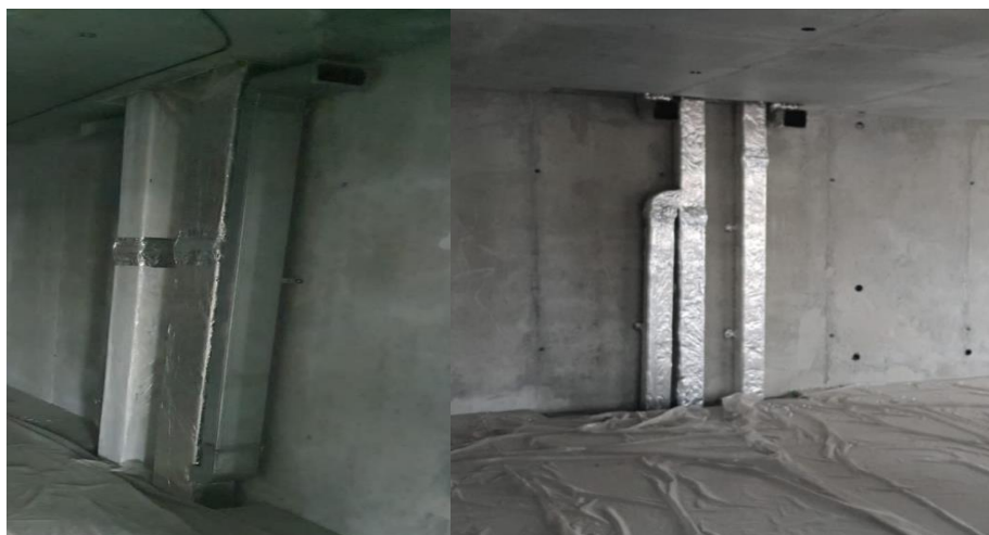
Рис. 4. Воздуховод приточных систем (слева) и воздуховоды вытяжных систем (справа)
