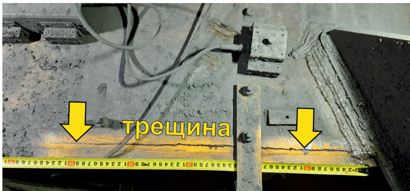
Рисунок 39. – Трещина в раме
