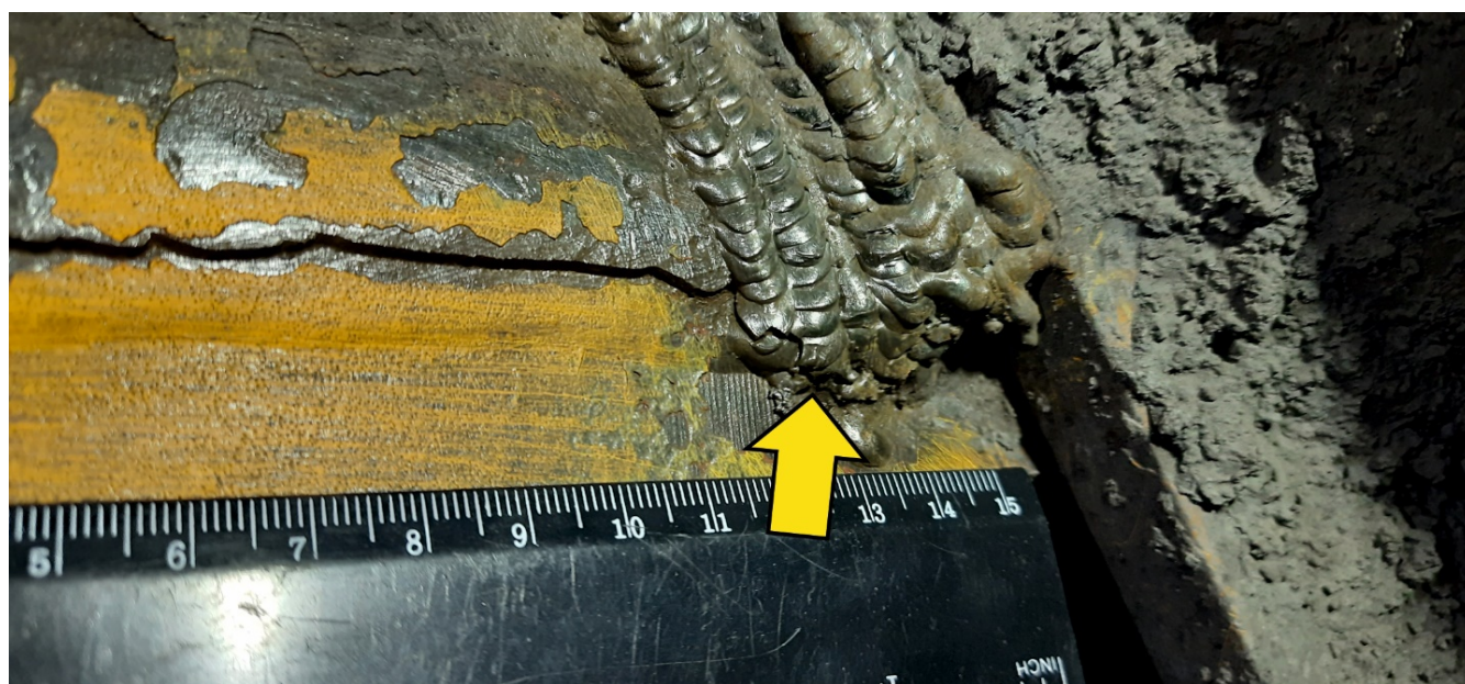
Рисунок 40. – Начало трещины в сварном шве приварки опоры двигателя
