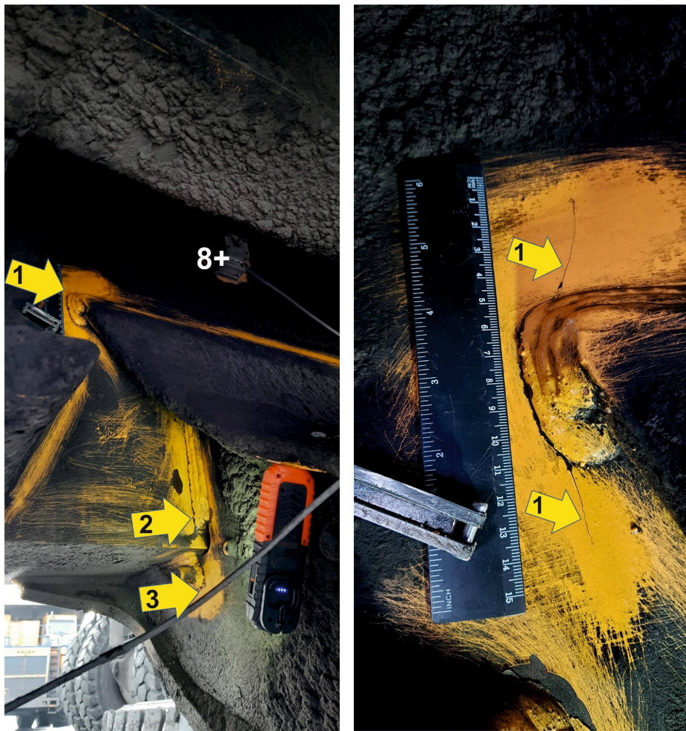
Рисунок 43. – Дефекты рамы, в районе 2-ой перемычки (датчик № 8)
