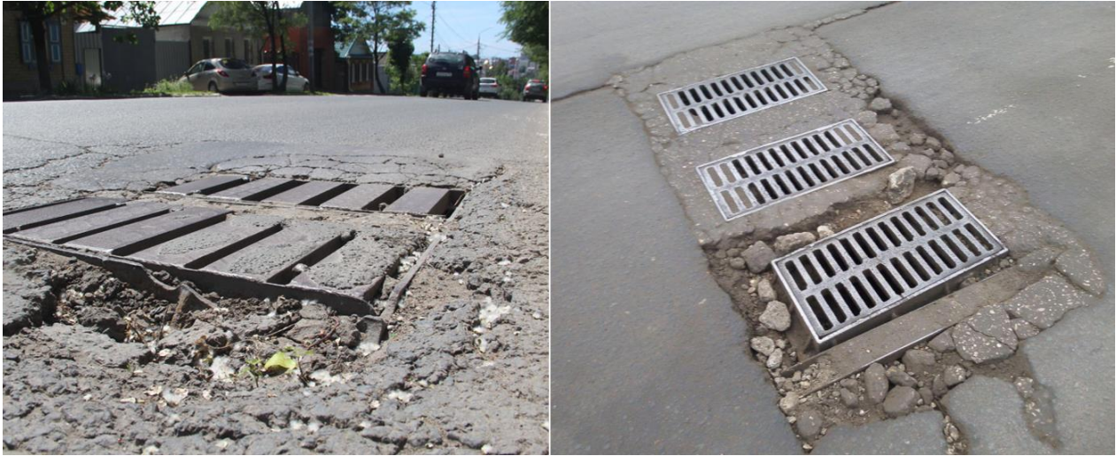
Рисунок 5 – разрушения покрытия у дождеприемников
