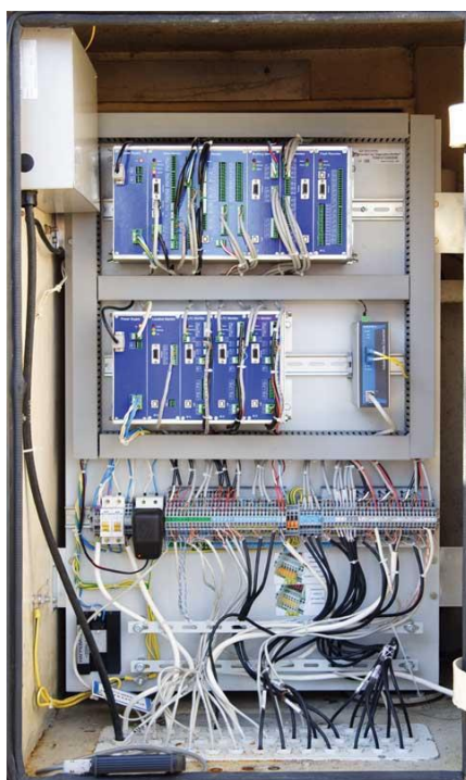
Рисунок 1 – Внутреннее устройства шкафа АСМД, производства ООО Димрус
