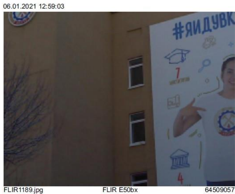
Рис. 2. Термограмма стыка двух частей здания со стороны улицы
