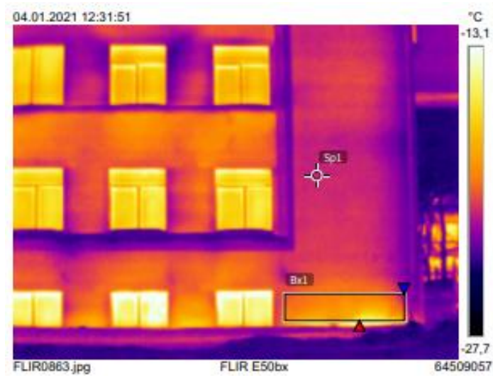
Рис. 1. Термограмма нижней части правого угла здания
