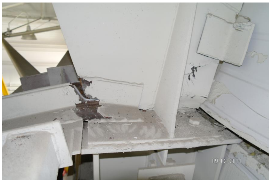
Рис. 5. Хрупкое разрушение нижнего пояса фермы
